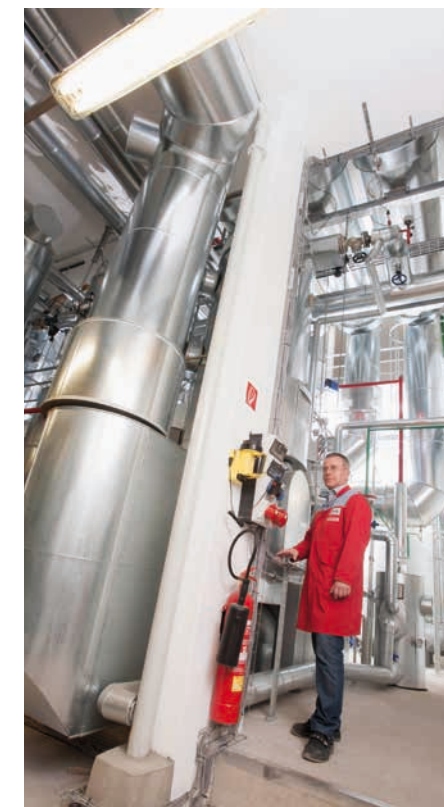
Wärmetauscher-Kaskaden des Blockheizkraftwerks mit dem leitenden Ingenieur Herrn Josef Scheuermeyer.
